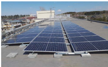
学校屋上に設置した太陽光パネル
