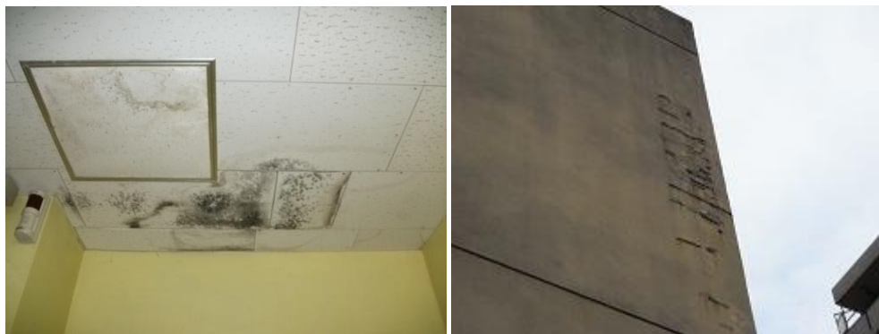
■図 2 雨漏りと外壁の剥落状況
