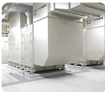
非常用発電機
