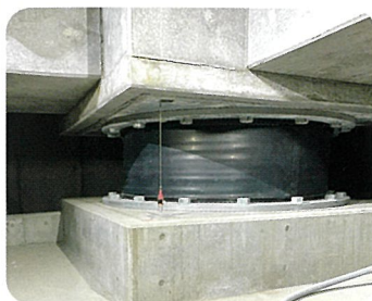
アイソレーター(積層ゴム支承)
