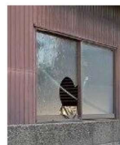
窓が割れた 管理不全空家
