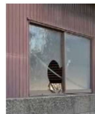
窓が割れた 管理不全空家
