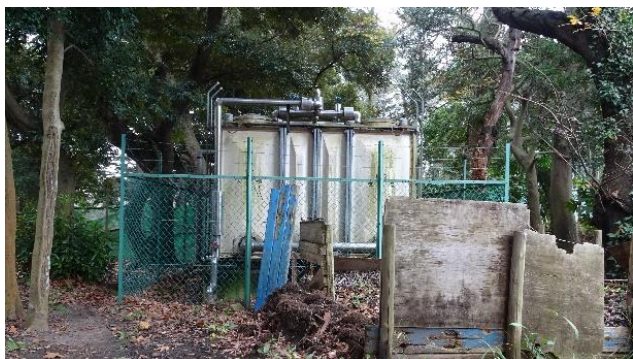
47ポンプ室付受水槽
