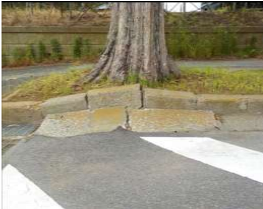
根上りにより道路施設を破損しているメタセコイア
