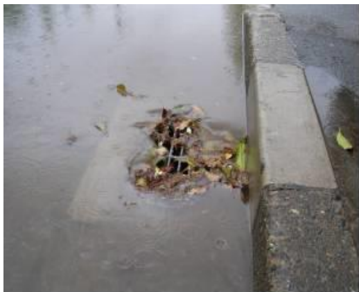
落葉が排水溝に詰まり道路が冠水している様子
