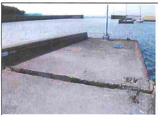
目地部分の断裂
