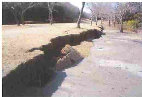
花見川緑地(隆起・陥没)
