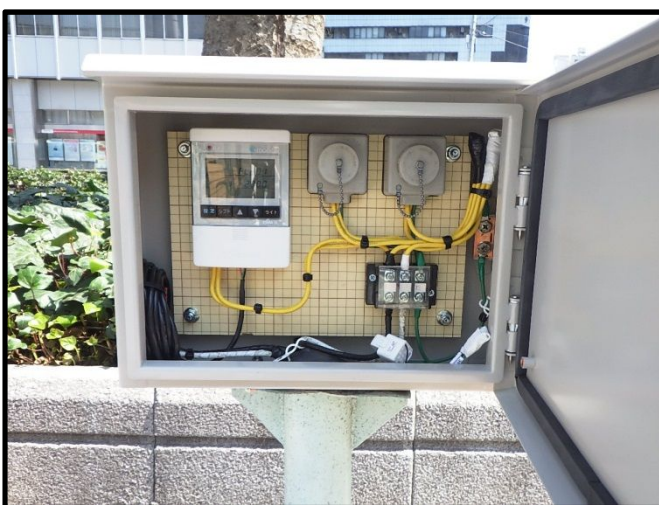
ボックス内 モニターとコンセント2口
