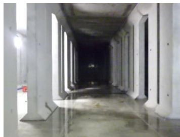
雨水を貯め、浸水から 街の安全をまもる雨水貯留槽 (1)
