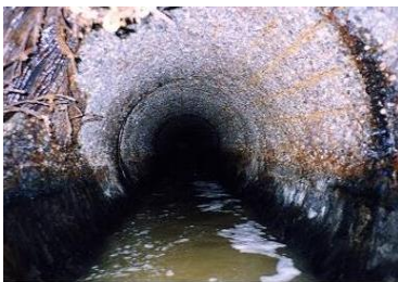
劣化した下水道管 (2)
