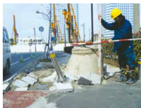
課題 地震で浮いたマンホール
