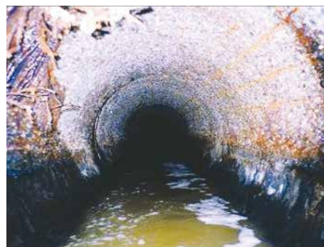
課題 劣化した下水道管
