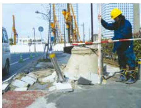
課題 地震で浮いたマンホール
