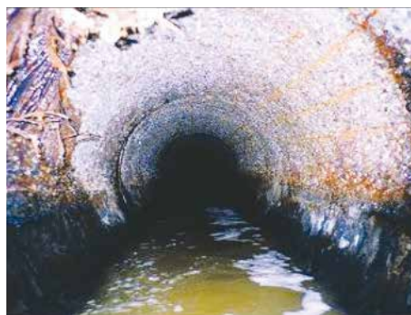
課題 劣化した下水道管
