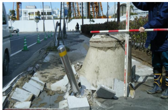
人孔隆起状況（東日本大震災）
