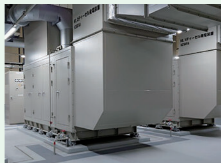
非常用発電機
