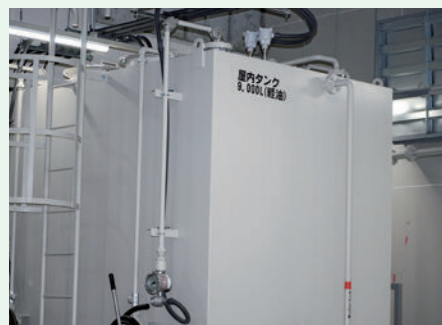
オイルタンク
