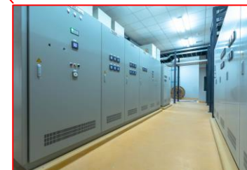
受変電設備 (キュービクル)
