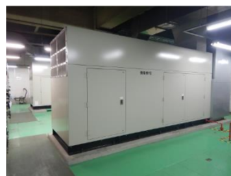
図2-5 浄化センターの非常用発電機
