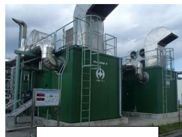
消化ガス発電機
