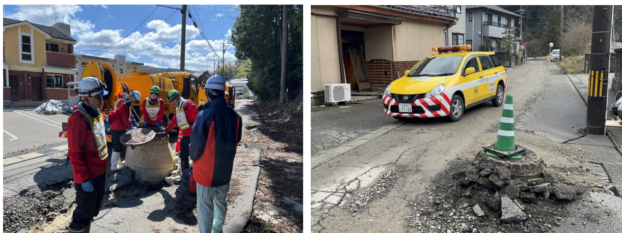
図 1-3 令和6年能登半島地震におけるマンホール隆起(輪島市)
