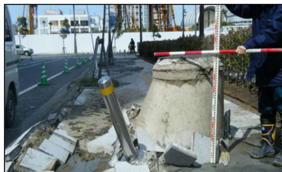
東日本大震災における被災状況
