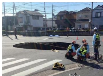
写真：道路陥没の事例
