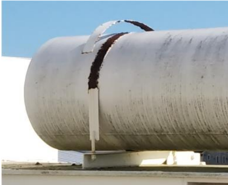
破損した固定バンド (マフラーに穴は開いていません)
