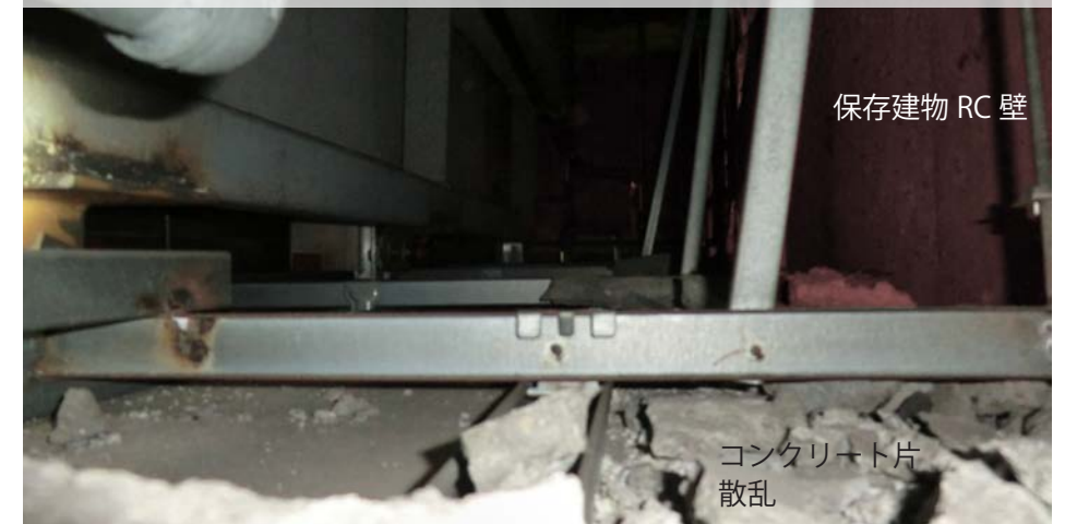
F 鉄骨梁と保存建物の接合部欠損、保存側壁上部鉄筋露出
