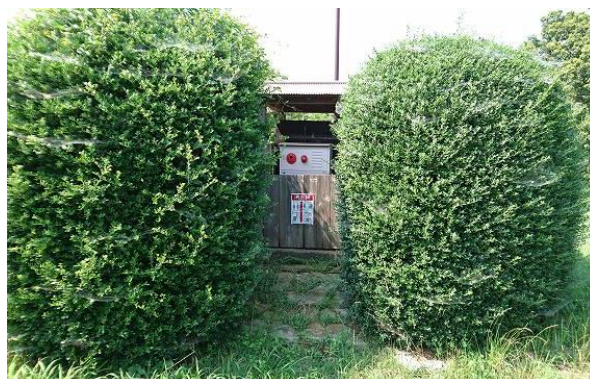
消火栓の設置（加曽利貝塚）
