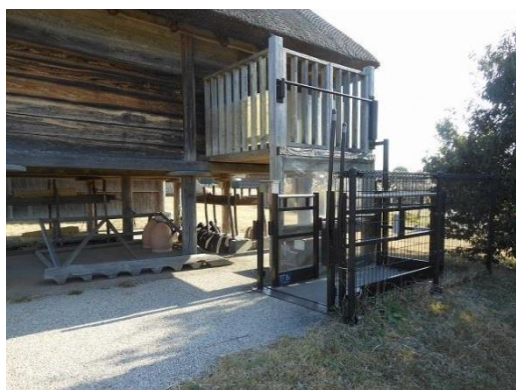
復元建物に設置された昇降機
