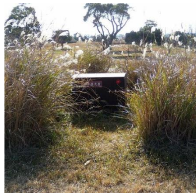
植栽による屋外消火栓の修景
