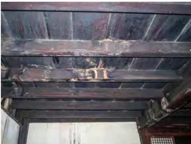
雨漏り跡 北西部
