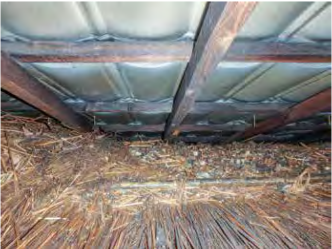
金属瓦 垂木と桟木のみで構成され、野地板がなく、構造的に脆弱。
