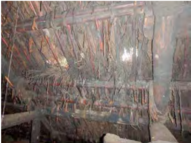
雨漏り箇所 背面側 ざしき上部
