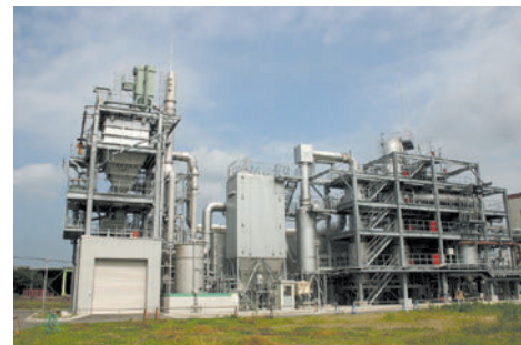
⑨ 汚泥焼却設備
