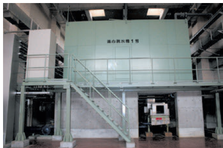
② 汚泥処理棟（汚泥脱水設備）
