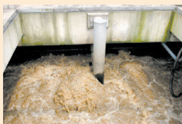
高度処理施設（好気槽）
