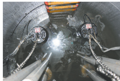
マンホールポンプ
