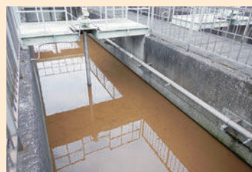
高度処理施設（無酸素槽）
