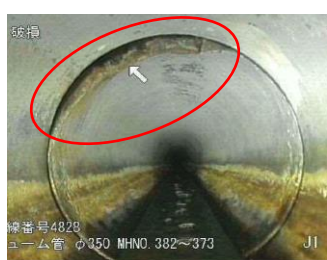
緊急度Ⅱ(破損)
