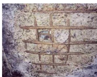
緊急度Ⅰ(腐食)
