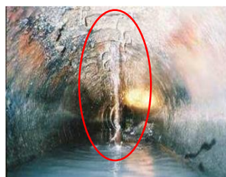
緊急度Ⅱ(浸入水)
