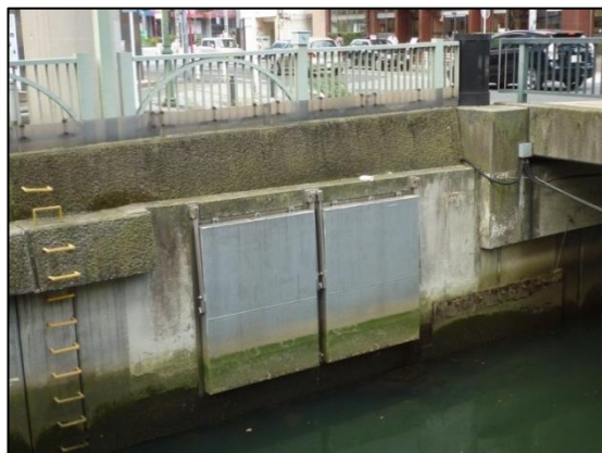
晴天時の雨水吐の状況(千葉市中央区富士見1丁目 : 葭川)
