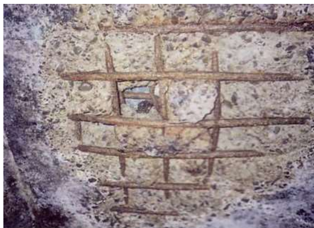
腐食し、鉄筋が露出
