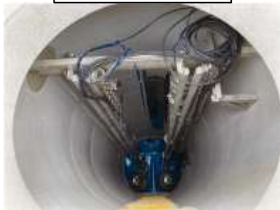
新設ポンプ設備
