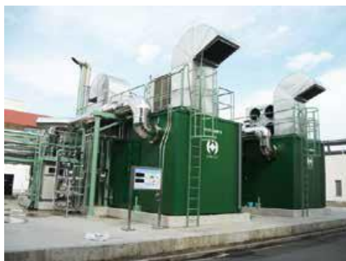
南部浄化センターに導入した消化ガス発電設備
