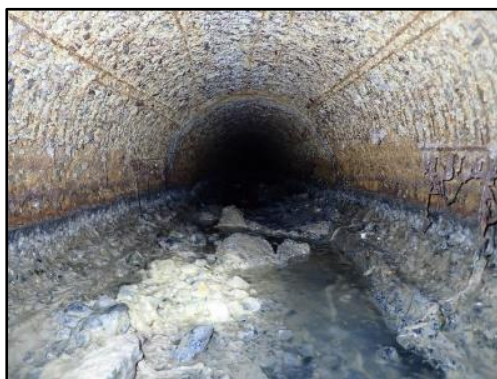
腐食した管きょ
