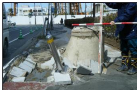
東日本大震災被災状況（美浜区）
