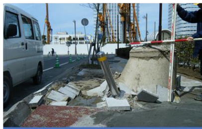
液状化被害（実績）
