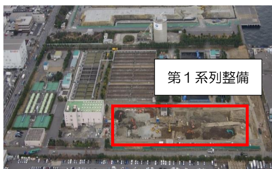
中央浄化センター
