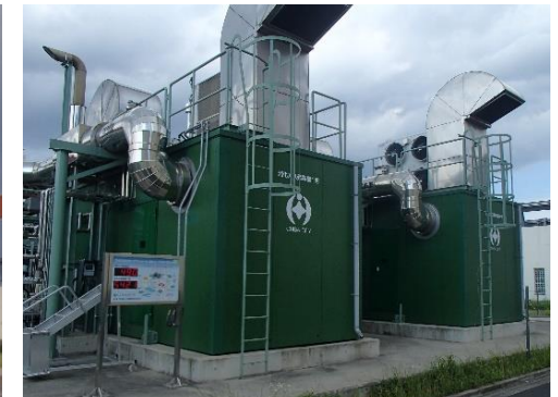
消化ガス発電設備
