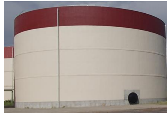
汚泥消化タンク
