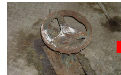
老朽化した設備
