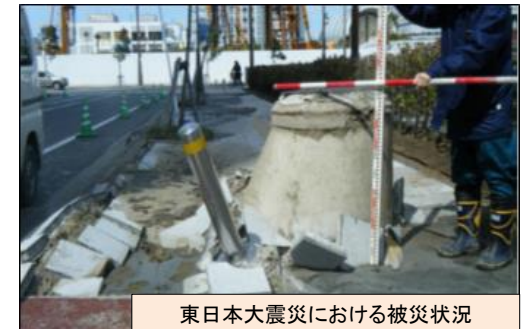
東日本大震災における被災状況
