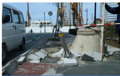
液状化被害（実績）
