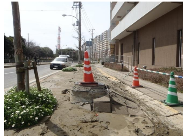
【マンホールの浮上】
