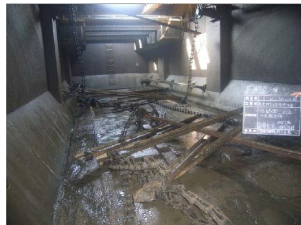
【汚泥掻寄機の破損 (チェーンの破断等)】
