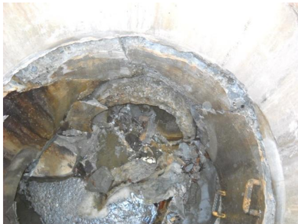
【マンホール、管口の破損】
