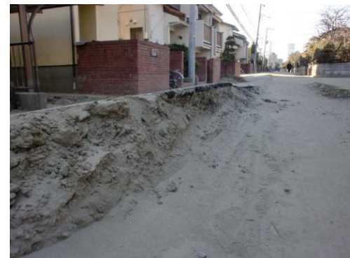
【液状化の状況(美浜区)】
