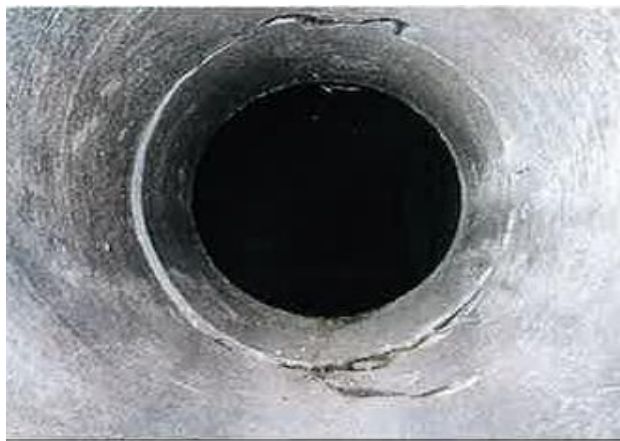
【管きよの破損(ひび割れ)】
