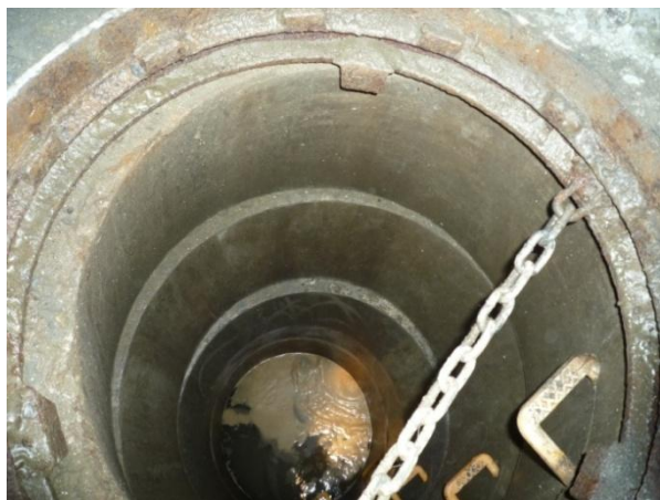
【マンホールのズレ】
