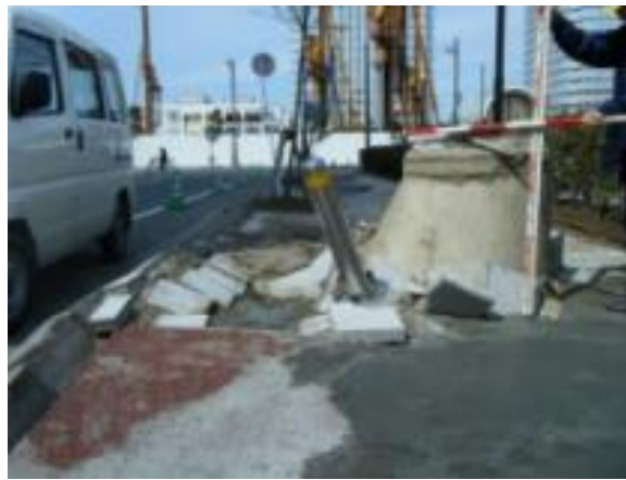
【マンホールの浮上】
