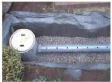
雨水浸透トレンチ
