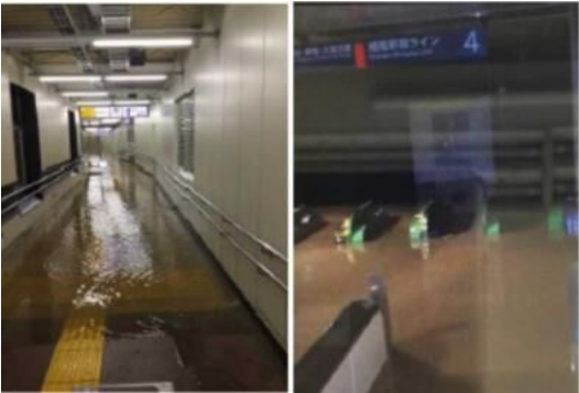
（ＪＲ武蔵小杉駅構内内水被害）
