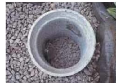
雨水浸透ます
