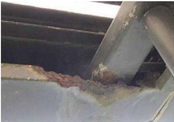
写真 4 腐食損傷写真
