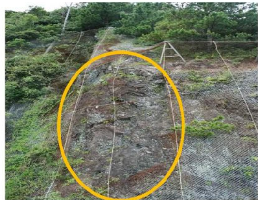
写真 4-7 落石防護網の著しい腐食による断面欠損の例
