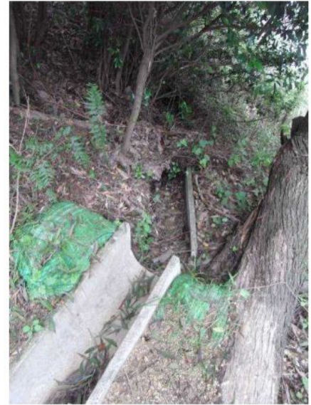
写真 4-5 排水溝の破損の例
