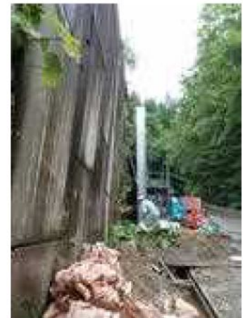
写真 4-4 壁面の傾斜の例
