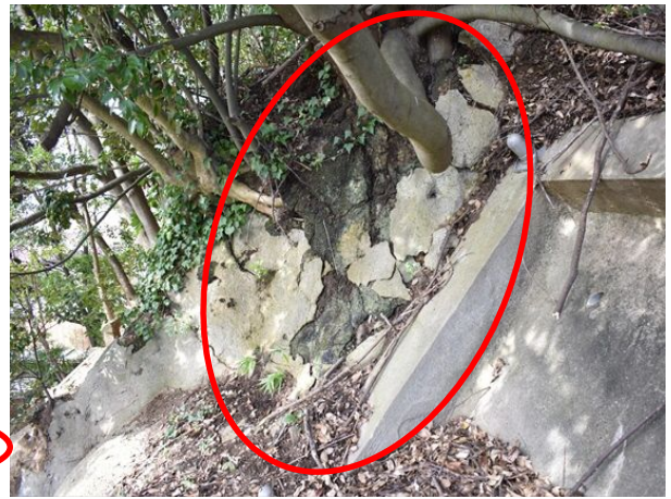
吹付けコンクリートの剥離
