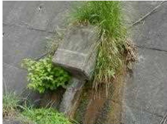
写真 4-2 アンカーの頭部からの 湧水・雑草の繁茂の例
