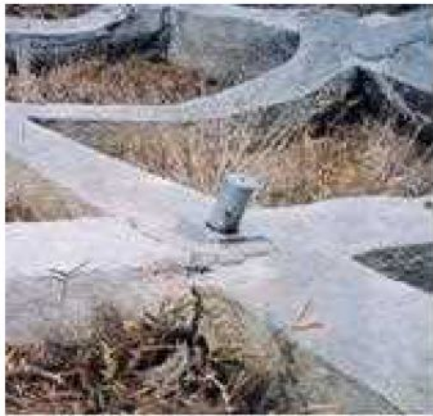
写真 4-1 受圧構造物の破損の例
