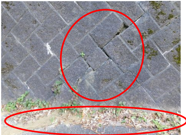
石積み擁壁のクラック、土砂の流出
