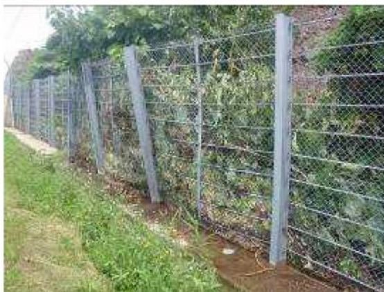
写真 4-6 落石防護柵の傾動の例
