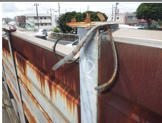
写真 13 磯辺畑町線（花園陸橋（JR）） 腐食による落下防止ワイヤーの破断
