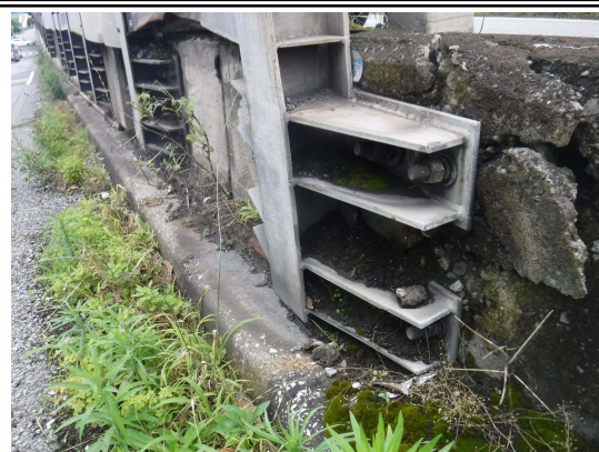
写真 12 中瀬幕張本郷線（幕張陸橋） 車両衝突による基部破損
