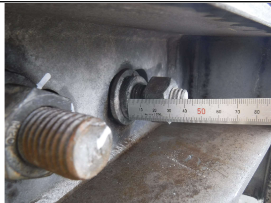
写真 11 中瀬幕張本郷線（幕張陸橋） ボルトの緩み
