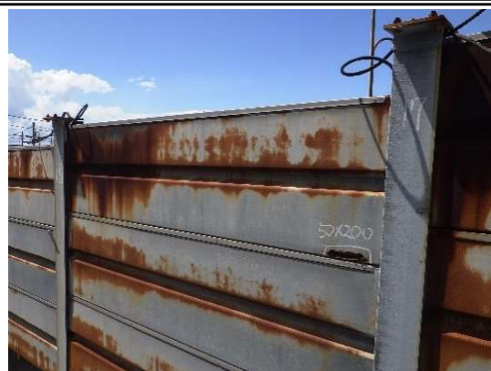
写真 14 磯辺畑町線（花園陸橋（JR）） 遮音パネルの腐食
