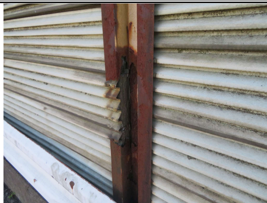
写真 15 千葉大網線（菅田跨線橋） 支柱の腐食
