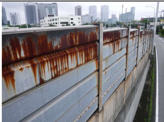
写真 10 中瀬幕張本郷線（浜田陸橋） 経年劣化による腐食
