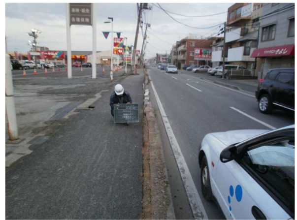
液状化による電柱の傾斜（千葉市）
