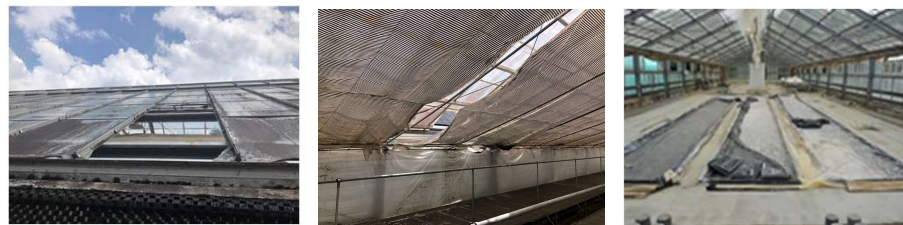
天窓等が破損し、未利用のままとなっている
