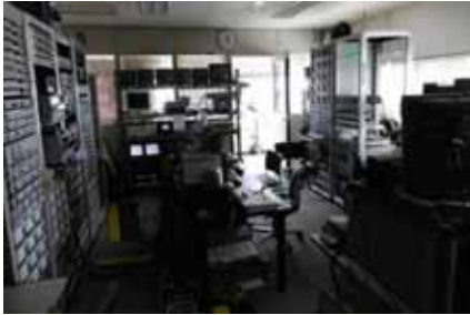
▼テレビ室(統制室内)
