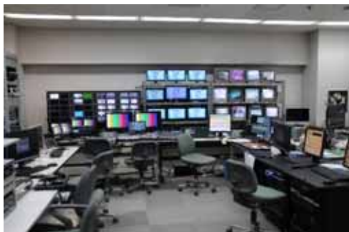
▼テレビ室(統制室内)
