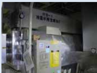
MS (4F) 冷温水発生機
