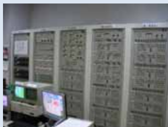
MS (4F) 統制室 パナソニック製放送設備
