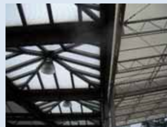
その他設備の不具合 (雨漏り等)
