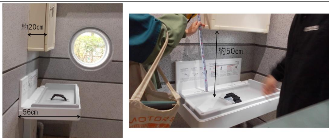
写真 おむつ交換台と分電盤の位置関係（施工後）
