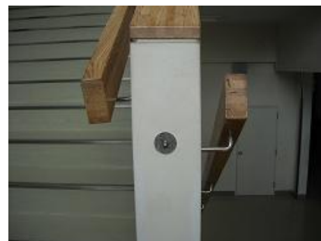
手すりが外れたままとなっているケース
