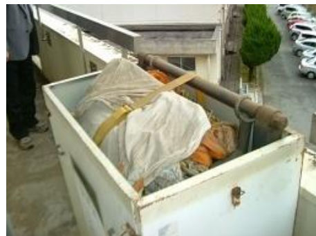
救助袋を固定する支持部（鉄パイプ） が腐食しているケース
