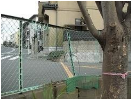
金網フェンスが破損しているケース
