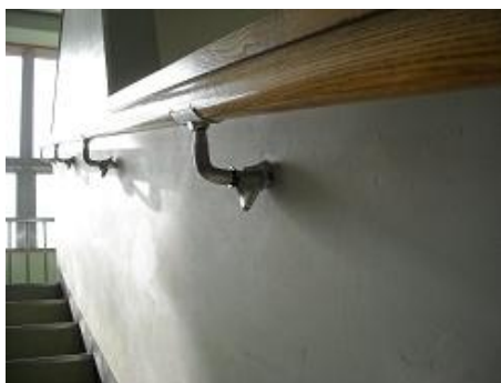
手すりがぐらついているケース
