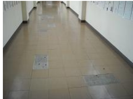
廊下のビニル床タイルが剥がれた ままとっているケース
