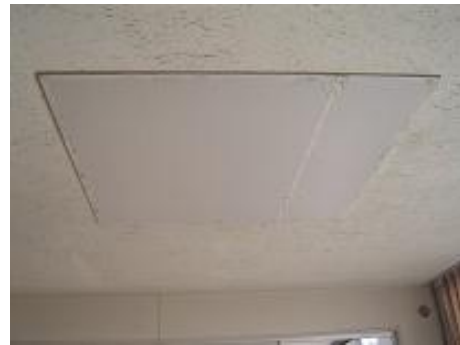
カバーが欠損し代替として障子紙を貼付して補修されていたケース
