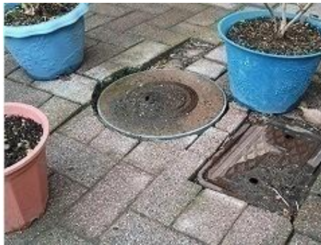
タイルに乱れが生じているケース
