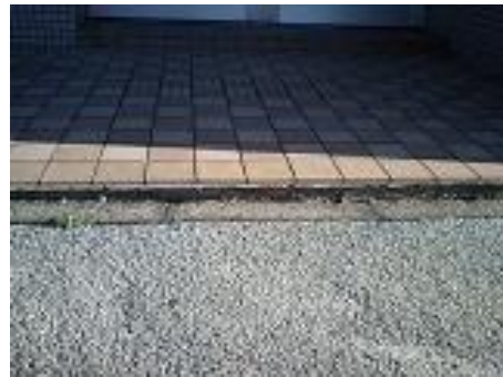
段差が生じているケース
