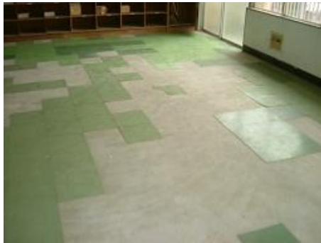
教室のビニル床タイルが剥がれた ままとっているケース
