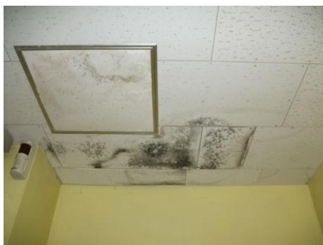
天井から浸水しているケース
