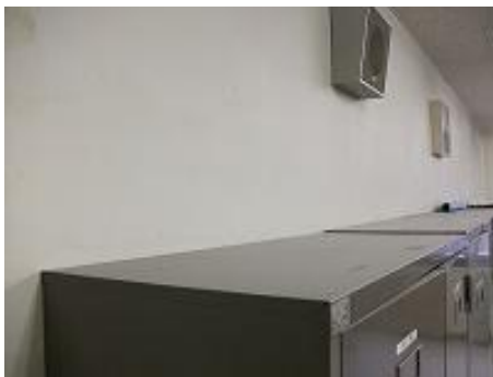
ロッカーがL字金具で壁に固定されていないケース
