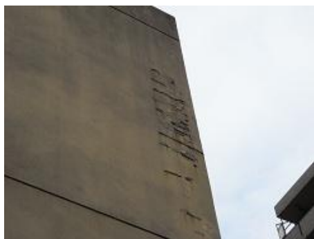
外壁が剥落し鉄筋がむき出しになっているケース
