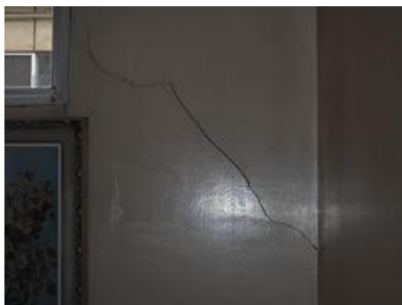
壁に亀裂が入っているケース
