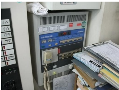
非常用放送設備が故障しているケース
