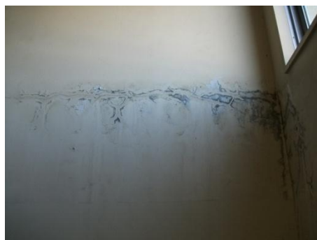
壁から浸水しているケース
