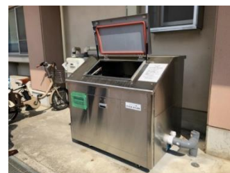
小学校に設置された生ごみ処理機 (小谷小学校)
