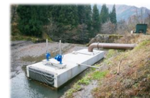
小水力発電施設
