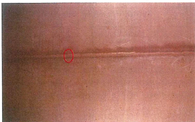
写真-1 GL+19.266(15° 付近) ピンホール状況
