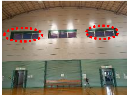
内部から見た排煙窓（開閉不能 2カ所）
