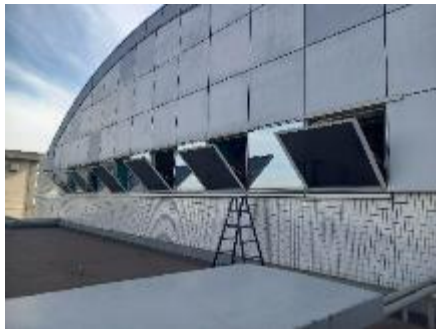
外部から見た排煙窓（開の状態）
