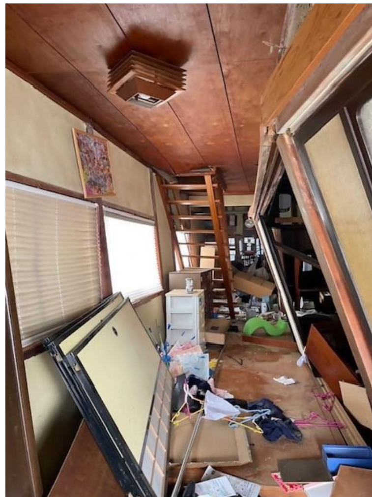
家屋内の被害状況(2)
