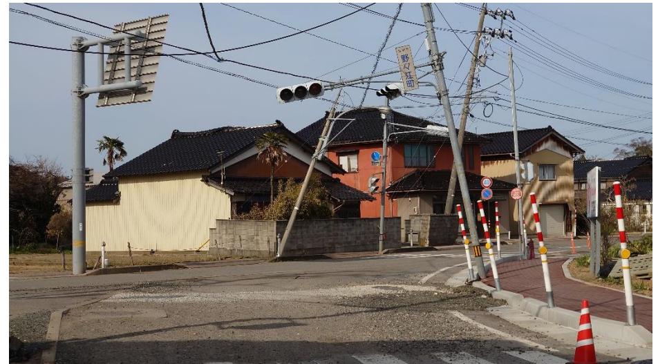
珠洲市街地における道路被害
